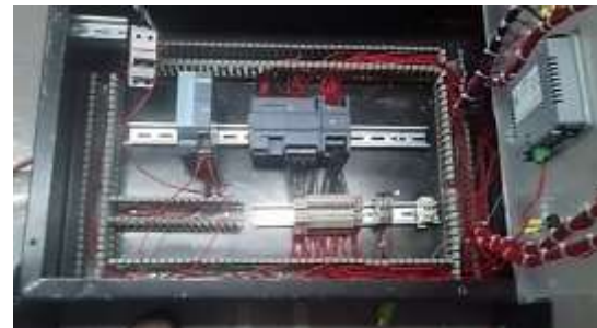
Figura 6. Módulo de control automatizado.
