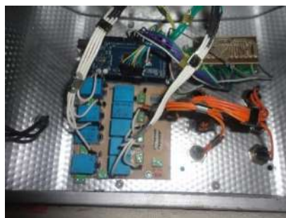
Figura 3. Panel de control con las vías de circulación de los fluidos.
