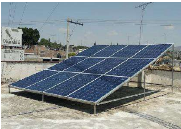
Figura 7. Sistema instalado de 12 paneles Canadian solar de 270 W.
